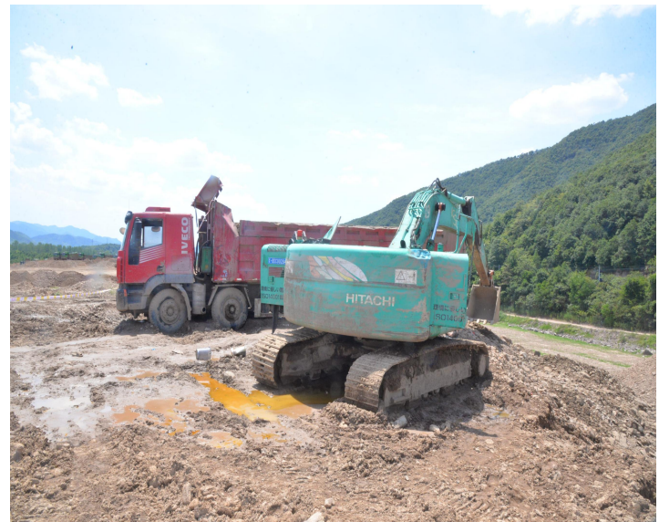
图7 涉事挖机周围水沟
